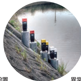
異常出水監視
